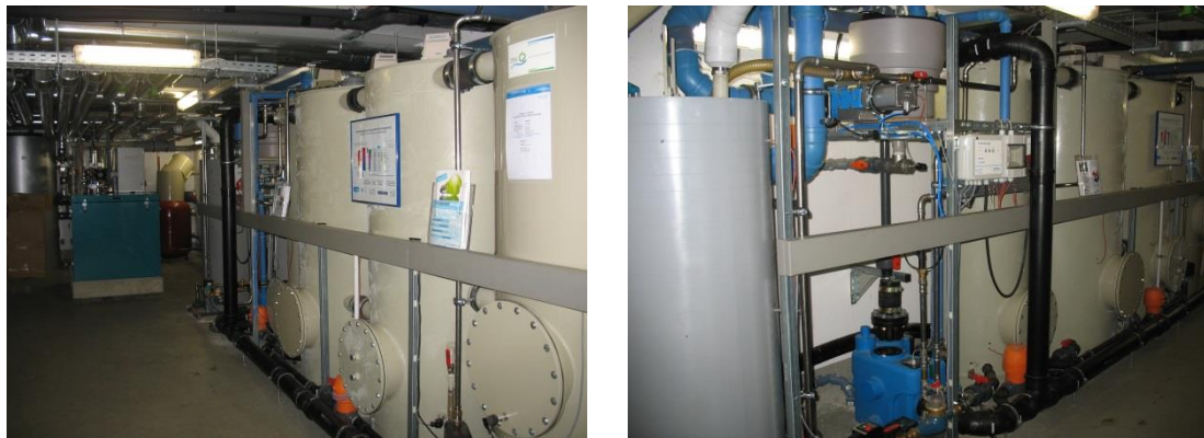
Abbildung 2: Grauwasserbehandlungsanlage mit Wärmerückgewinnung im Keller des Objekts A
