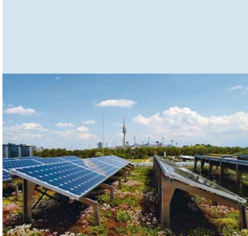
Die Kombination von Dachbegrünung und Photovoltaik-Anlagen verbindet nationale Strategien zur Förderung erneuerbarer Energien mit stadtoökologischen Aspekten
