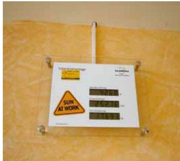
„Sun at work“, Datenanzeige der Photovoltaik-Anlage im Kinderhaus
